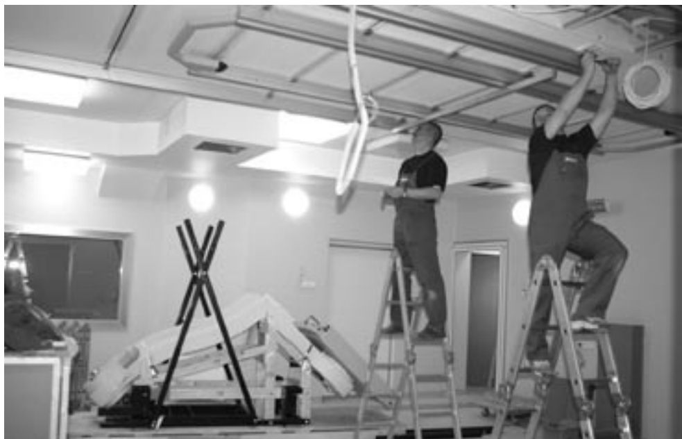
Każdy, nawet niewielki remont w szpitalu wymaga wymiany starych, zużytych, skorodowanych rur, przewodów, instalacji. I w ten sposób każdy mały remont robi się wielkim, w trakcie którego trzeba rujnować nie jedno pomieszczenie, a kilka.
